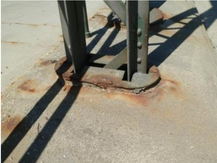
Ausgewählte Schäden oberliegenden Tragwerk
