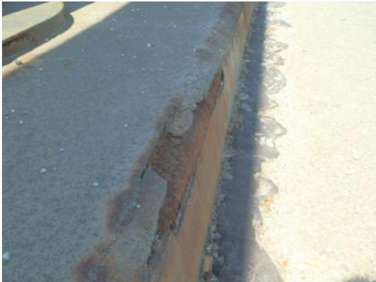
Ausgewählte Schäden obenliegenden Tragwerk
